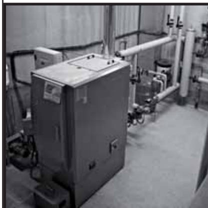
Nouvelle chaufferie à bois de la mairie de Myon
