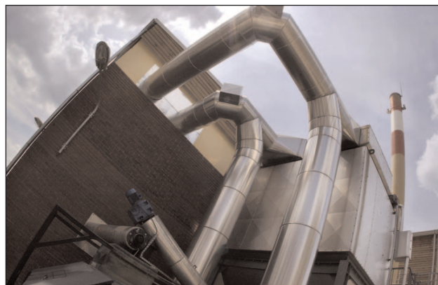
Grâce à sa nouvelle chaufferie, le camp militaire du Valdahon dispose d'un important réseau de chaleur. Photo Laurent Cheviet/collectif dcb
