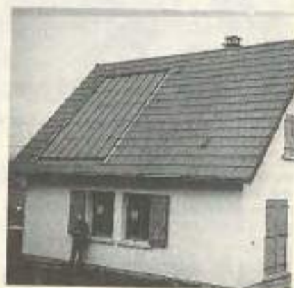
Chauffage par plancher solaire direct (17 m 2 de capteurs) à Paroy (25)
